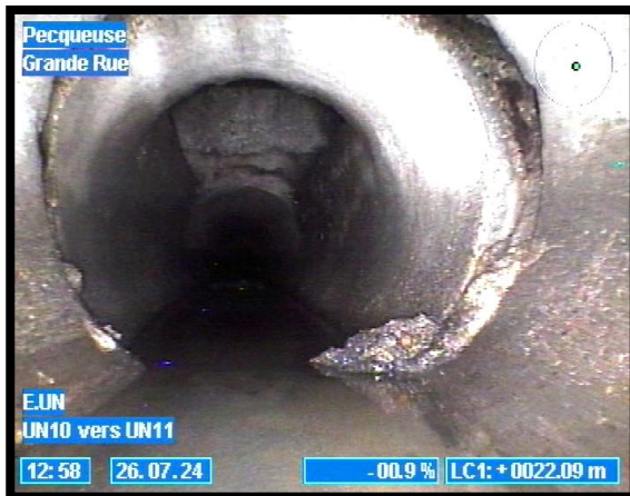
Effondrement partiel et paroi manquante
