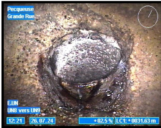
Raccordement mal renformi
